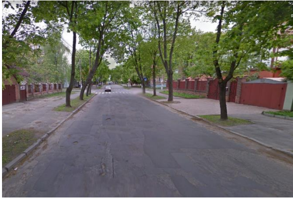
вул. Ружинська до ремонту
